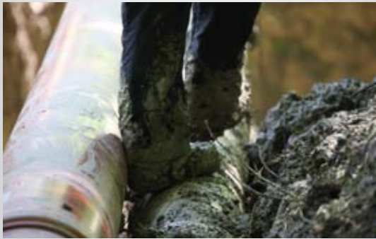
Bild unten: Nachdem sich Pioniere den Zugang zum Wasserlauf freigeschnitten hatten, sorgte eine improvisierte Rohrleitung für eine entsprechende Entwässerung des Grabens.
