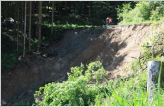
Bild oben: Zeigt den durch anhaltende Starkregenfälle verursachten Anriss der Rutschung. Das durchweichte Erdreich donnerte gemeinsam mit den Wassermassen zu Tal und verursachte grobe Schäden.
